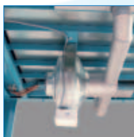
Ventilator voor luchttoevoer
